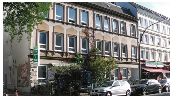
Müggenkampstraße 10-12 verfällt seit Jahren
